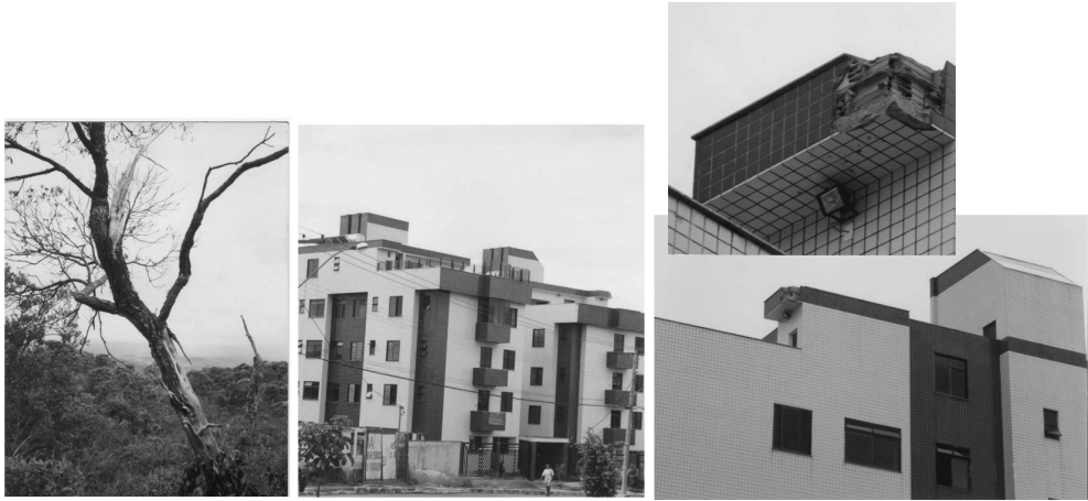
Figura 7.2 - Danos em árvore e em edificação devido à incidência de descarga atmosférica
